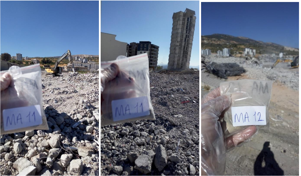
Şekil 7.b-c-d. Kahramanmaraş kent merkezinde, her iki tarafından da alınan örneklerde asbest tespit edilen yıkım/hafriyat çalışması alanı; sahadan görüntüler.
