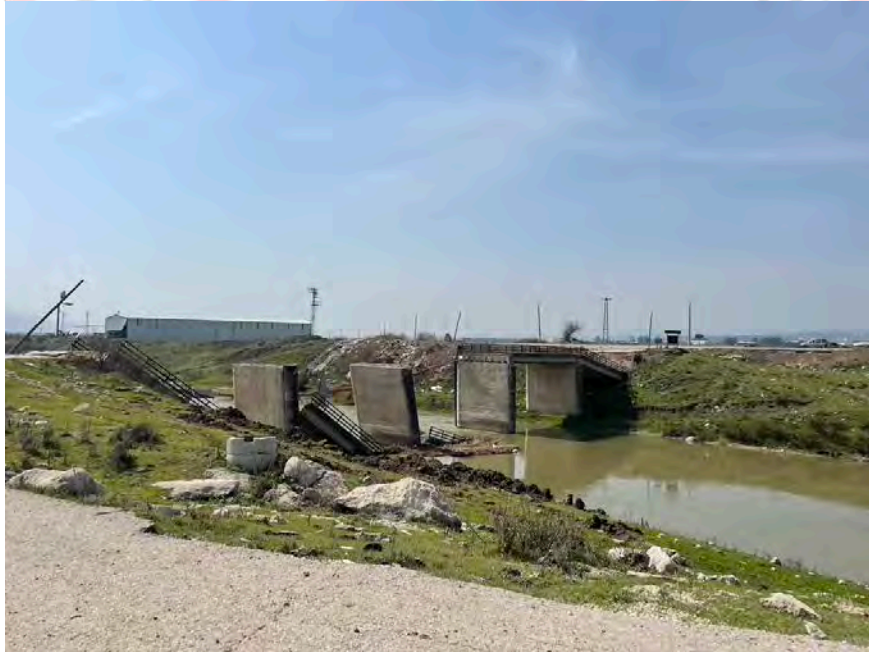
Hatay EAH'a ulaşım sağlanan yıkılan köprü
