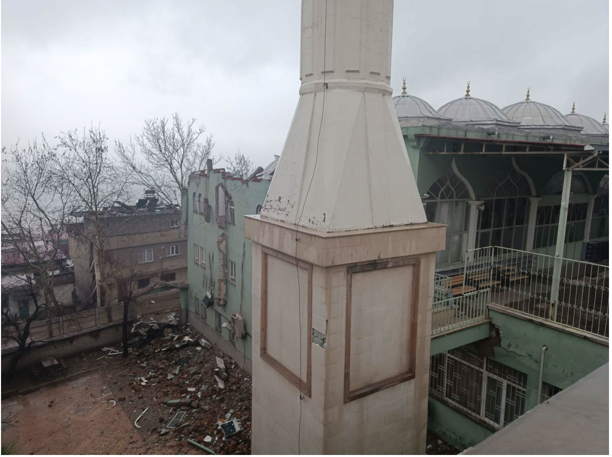
Fotoğraf-6.8: Kahramanmaraş 12 Şubat ilçesinde yer alan ağır hasar almış bir aile sağlığı merkezi
