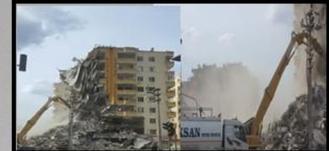
Osmaniye Hasar Görmüş Binaların Yıkımları
