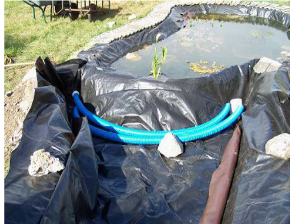
Fotoğraf 4- Arıtma sazlığı göletinin drenaj borusu. Kaynak: http://www.ecodiy.info/reedbed/ (112).
