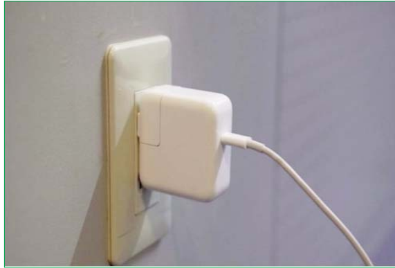
Resim-7: Kuaförlerde elektrik tehlikesi kaynağı fiş ve priz
